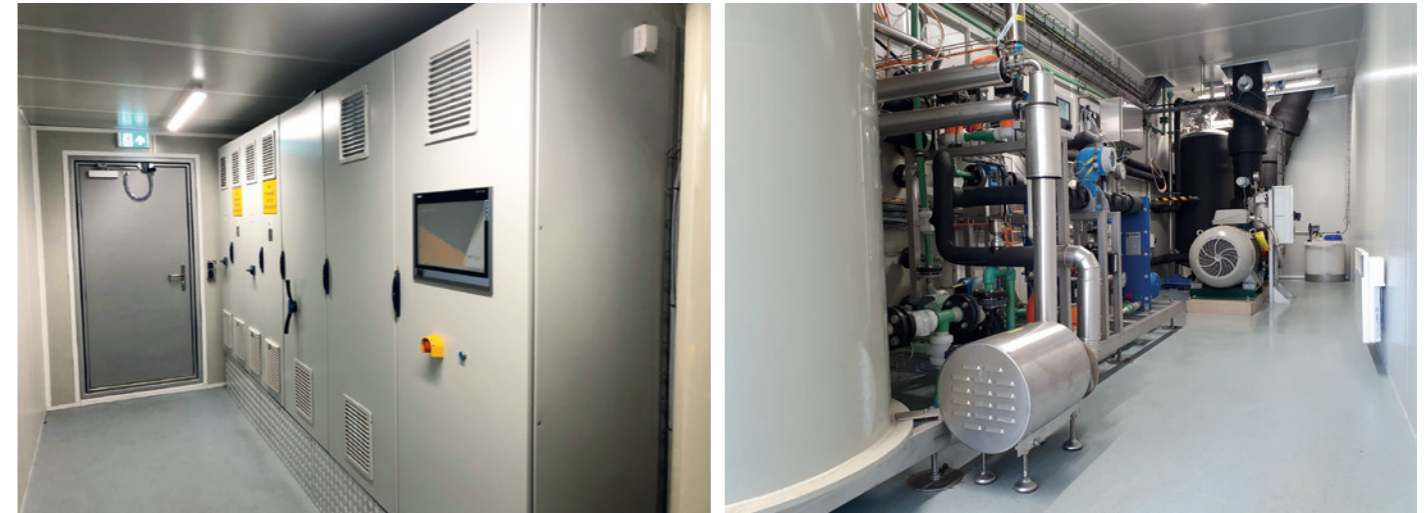
Bilder 5 und 6 Schaltschränke und Umwälzpumpe Quelle: Salltech B. V.
