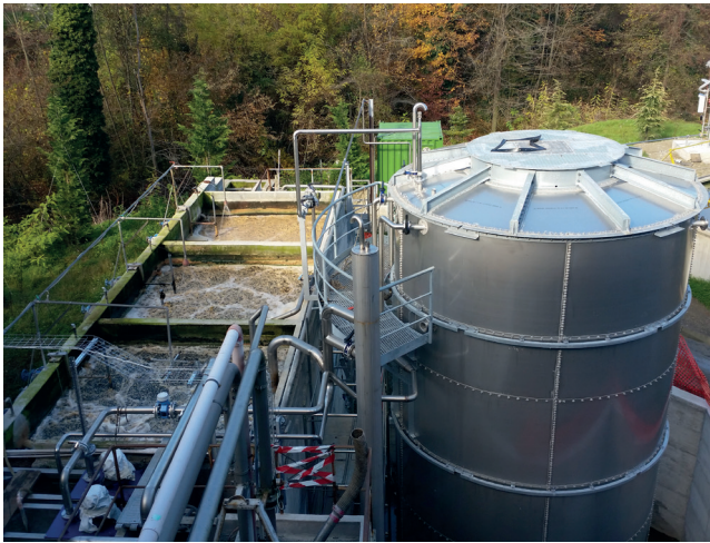
Abb. 2: Vor der bestehenden, aeroben Abwasseraufbereitung installierter DACS-Reaktor
